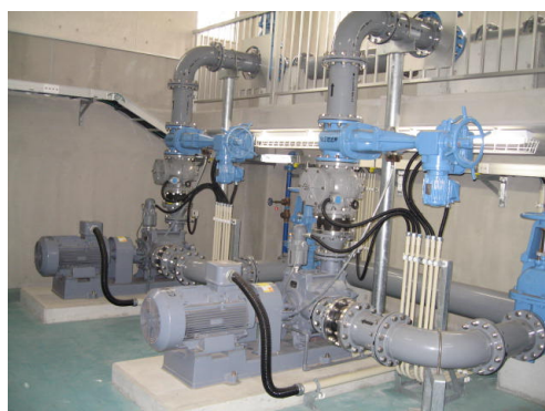
四三嶋受水場：中継ポンプ施設（城山配水場へ送水）
