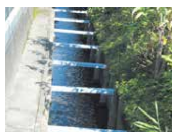
劣化している板柵
