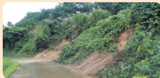
小規模崩落した三並区の法面
