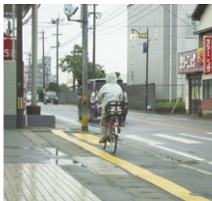
途切れた危険な歩道帯
