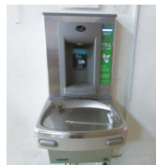
ボトルフィルタータイプ冷水機の設置例
