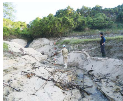
堆積している土砂(牧の池)
