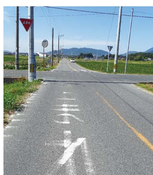
一部が消えかかった道路標示
