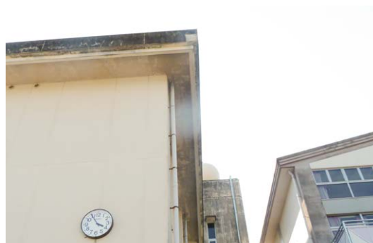
モルタルが剥離した校舎
