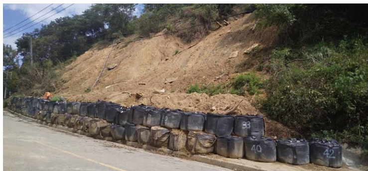
山麓線の土砂災害の現場
