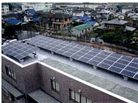
■車庫棟屋上 20kW 設置
