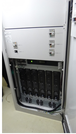
●蓄電池(ケース内部)
