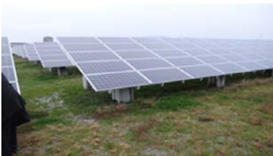
●太陽光パネル
