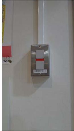
●非常用コンセント
