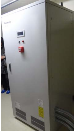
●蓄電池(ケース外部)
