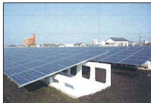
図 4-4②コンクリート製基礎架台
